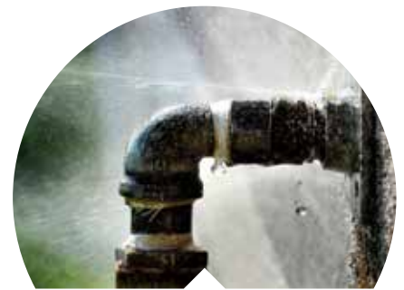
Evita las corrosiones por punto.
